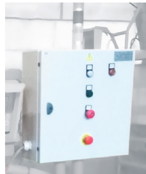
Стационарный пульт управления системами агрегата
